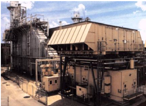
GT Cogen (GE)
